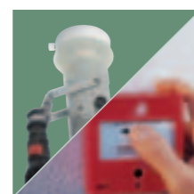
Contrôle des boucles de détecteurs automatiques et de déclencheurs manuels
